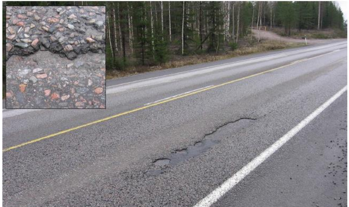
Kuva 23. Varsin ohut SMA16/70 -päällyste on purkautunut valtatiellä 25 Hyvinkäällä.
