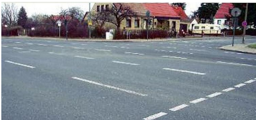
Intensiivselt koormatud II kategooria tee, mille katend on projekteeritud spetsiifilisest asfaltsegust. Vaatamata pikale kasutusajale ei ole deformatsioone tekkinud.
